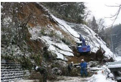
【写真②】 平成17年1月法面崩壊 (国道183号庄原市西城町) 【全面通行止め106時間、片側交互通行350日】
